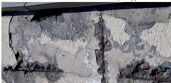
Следы коррозии бетона
