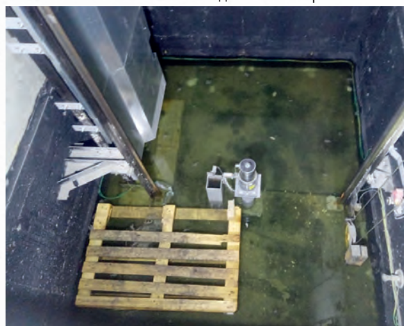
Вода в шахте лифта: была и нет
